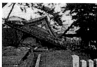
写真2 地震被害例 3) (B)
