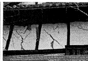
写真5 地震被害例 3) (土壁の亀裂)
